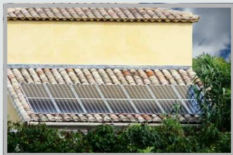
Panneau solaire intégré à l'habitation
